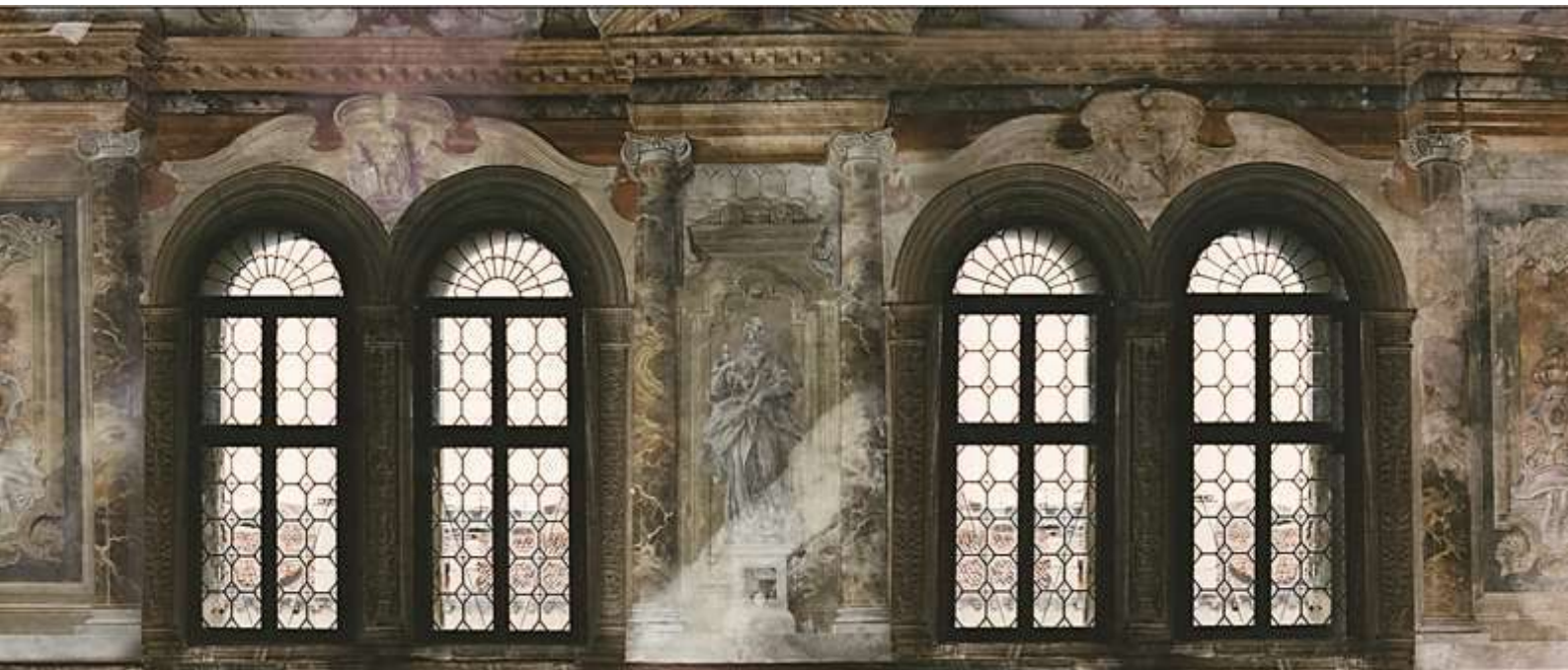
Fig. 3 Parete nord, prima del restauro. Al centro delle due finestre è collocata la figura del Consiglio, mentre sopra gli archi sono visibili i simboli di san Marco (leone alato) e san Giovanni (aquila) Evangelisti. È evidente la situazione di degrado dovuto all'umidità e ai sali che causavano sbiancamenti e perdita di materiali, specialmente nella parte inferiore della parete.
