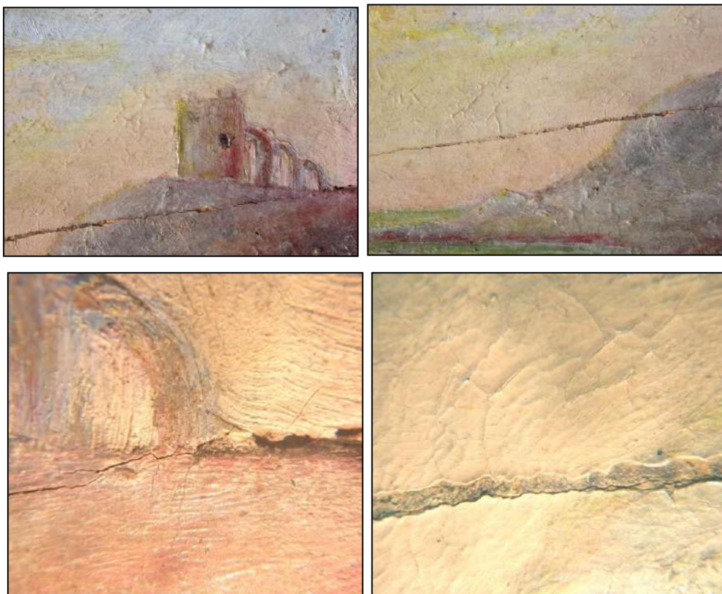
32, 33, 34, 35. Particolari e ingrandimenti della fessurazione
