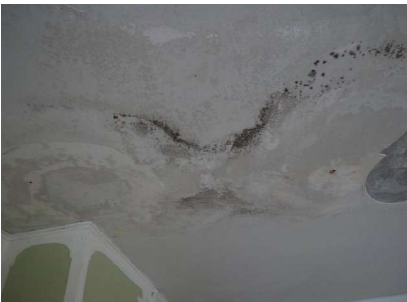
Figura 26. Il soffitto presentava le classiche macchie, "gore", da ristagno di acqua ed efflorescenze. Si vede inoltre la colonizzazione a macchioline brune tipica dei funghi meristemati, le cosiddette muffe.
