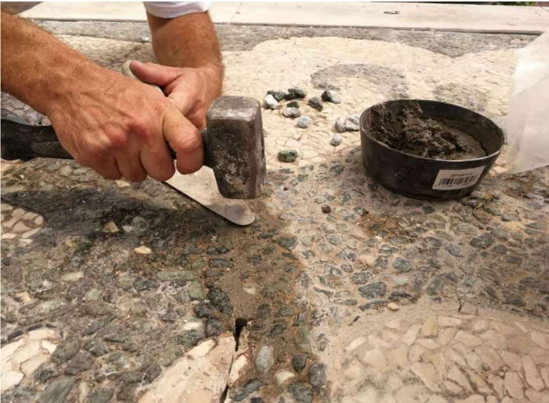
Figura 63. Fase di “battitura” delle nuove scaglie di marmo all’interno delle fessure da ripristinare.
