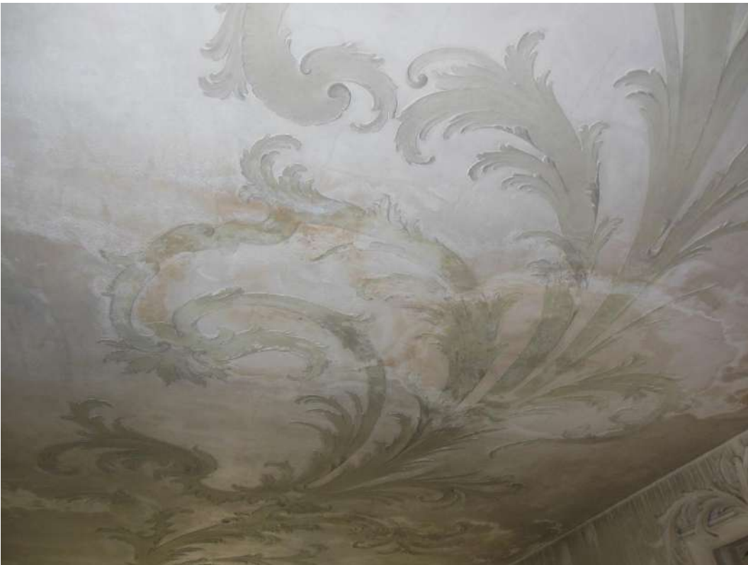
Figura 36. Gore ed efflorescenze.
