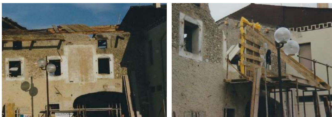
Figura 34: incollaggio dei sacchi di juta e delle assi di legno sul fronte a protezione della pellicola pittorica
