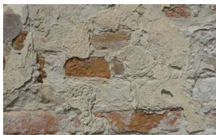
Foto 35. Fronte est: arenizzazione.
