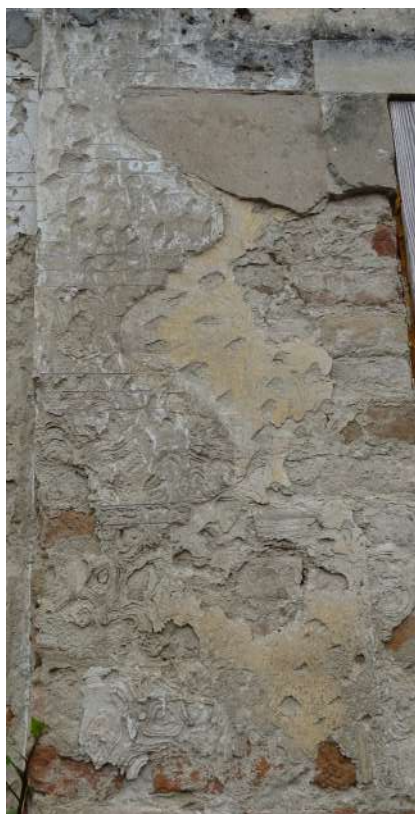
Foto 33. Fronte est: distacco degli intonaci.
