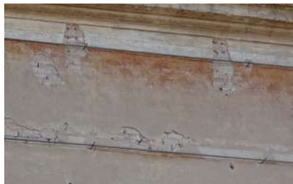
Foto 32. Fronte sud: sfrarinamento del colore dello strato n.5.
