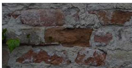
Foto 36. Fronte est: erosione dei laterizi.
