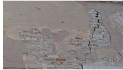
Foto 37. Fronte sud: fessurazione
