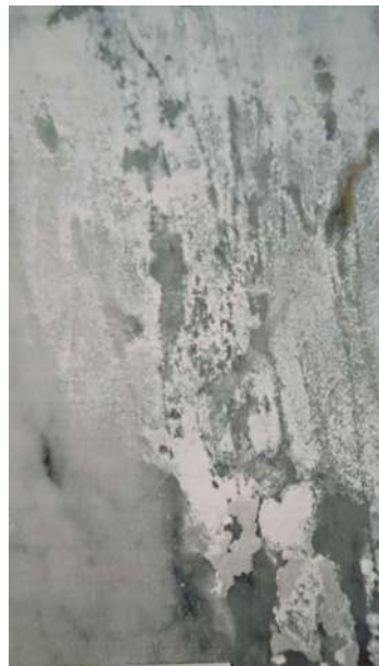
Fig. 2.5. Aspetto delle efflorescenze su un determinato materiale lapideo.
