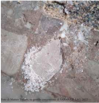
Fig 3.2. Strato di cristallizzazione dei Sali sotto le vecchie stuccature.
