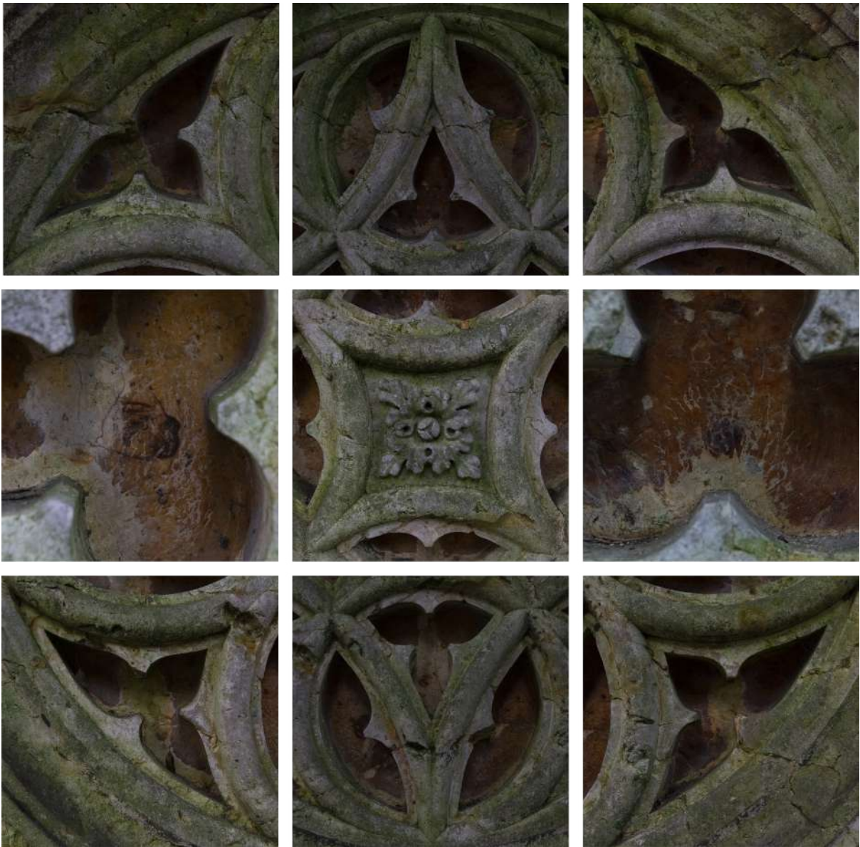
Fig.18-26-: Dettagli delle forme di degrado riscontrabili sulla superficie frontale del manufatto: colonizzazione biologica, fessurazioni, mancanze di modellato e alterazioni cromatiche. Foto dell'autrice, febbraio 2025
